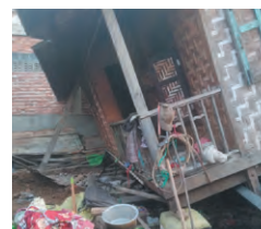
倒壊した現地社員自宅
